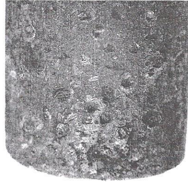
Attacco elettrochimico da parte dell'ossigeno sulla superficie esterna di tubi di fumo in una caldaia a vapore.
