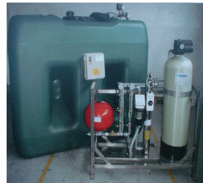
Impianto di Sterilizzazione con UV
