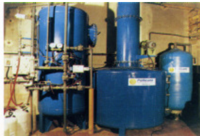
Impianto di Decarbonazione, strippaggio CO 2 e addolcimento finale, installato presso una tintoria.
